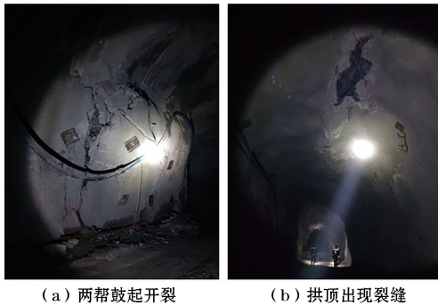
图 1 现场巷道围岩变形破坏情况
